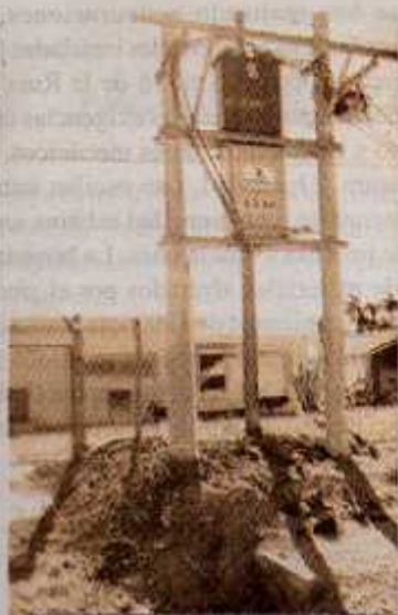
Subestación de UTE para los edificios del Archivo
